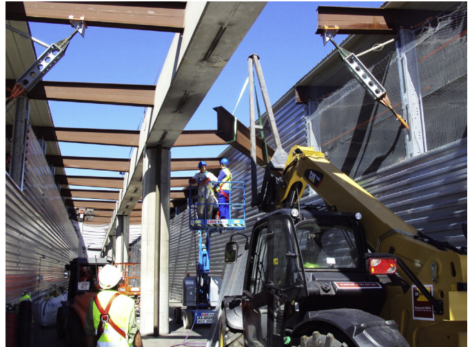
Figura 41. Demolición de las marquesinas existentes entre túneles provisionales para la protección de vías.
