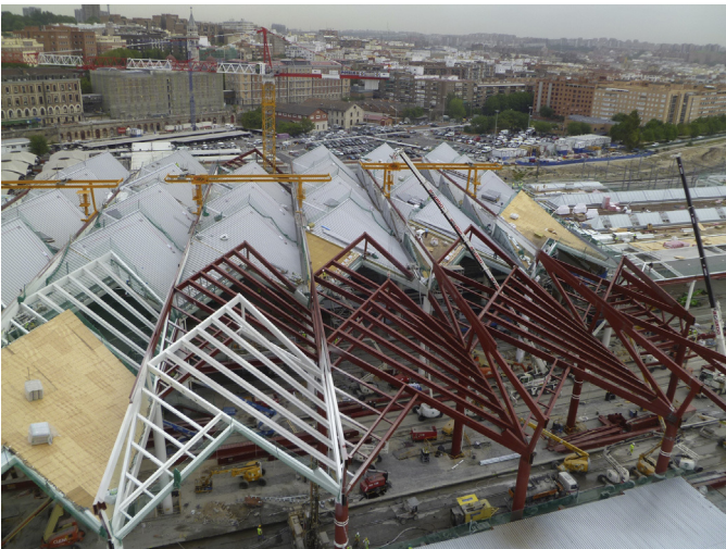
Figura 51. Puentes grúa sobre la cubierta alta.
