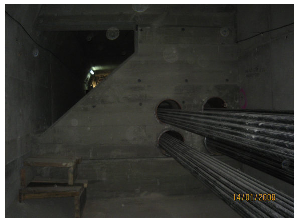
Figura 29. Vista del pretensado exterior dentro del cajón atravesando un rigidizador transversal dispuesto solo para limitar la distorsión del tablero.
