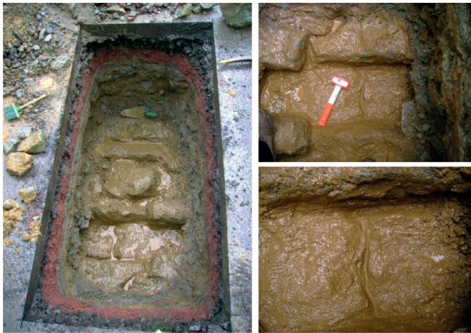
Figura 3. Cata y detalles de la calidad del aparejo, tamaño de bloques y espesores de juntas.
