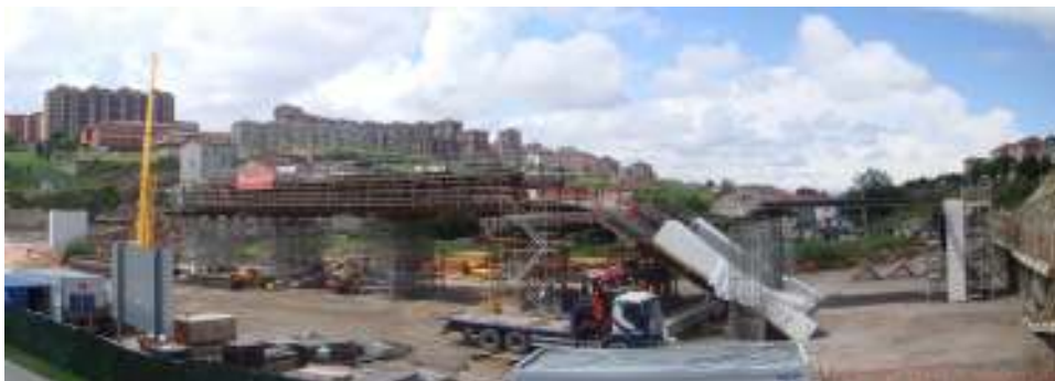
Figura 14. Vista de la cimbra porticada de cajón central de tablero y pies inclinados.
