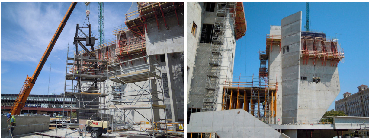
Figura 12. Montaje de la celosía metálica en el pilar mixto fusiforme. Vista del pilar hormigonado.
