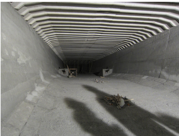
Figura 27. Vista del interior de la sección transversal con los anclajes de pretensado de positivos al fondo.
