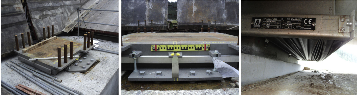
Figura 13. Vista de un apoyo, sistema de medición con regleta y protección guardapolvo.
