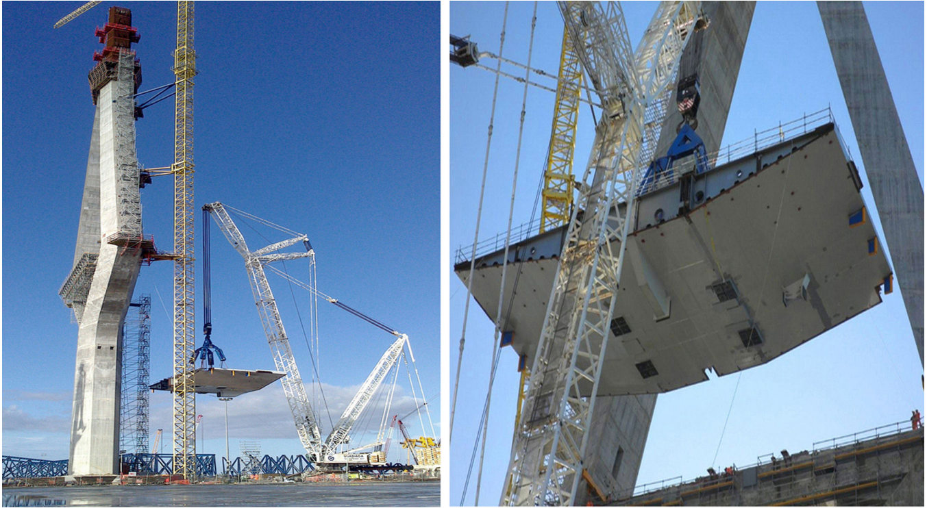
Figura 2. Izado de la dovela OP13 con los neoprenos para el apoyo provisional.
