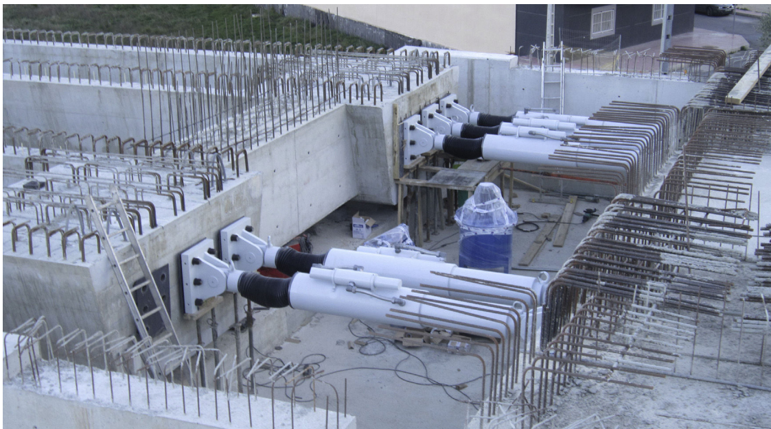
Figura 10. Fotografía detalle dispositivos antisísmicos en Viaducto Callosa-Cox.
