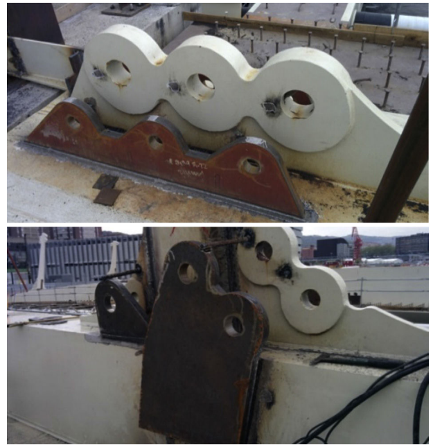
Figuras 46 y 47. Orejetas provisionales.
