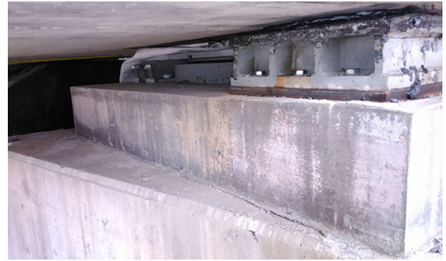
Figura 5. Detalle de chapas bajo apoyo temporal.
